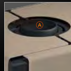
A Rookafvoer bovenkant
